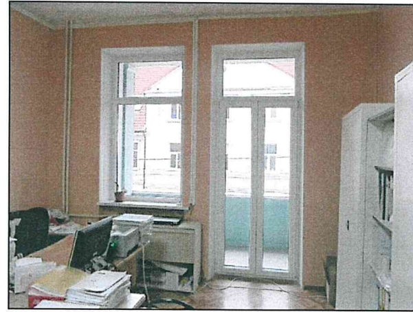
Фото 116. Второй этаж северной части объекта. Конструкции стен, перекрытий. Конструкции оконных, дверных проемов. Конструкции лоджии.
