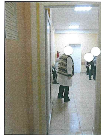
Фото 127. Третий этаж - мансарда северной, южной частей объекта. Конструкции стен, перекрытий. Конструкции дверных проемов.
