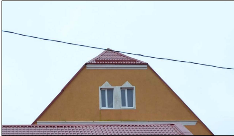
Наличники с фронтовыми сандриками оконных проемов чердачного помещения на северо-восточном (боковом) фасаде
