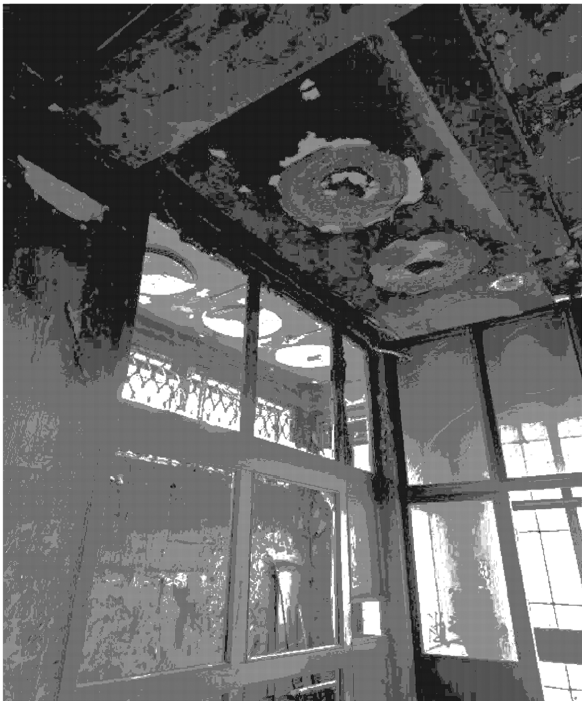
15. Местоположение утраченных потолочных розеток. Вид с юга.
